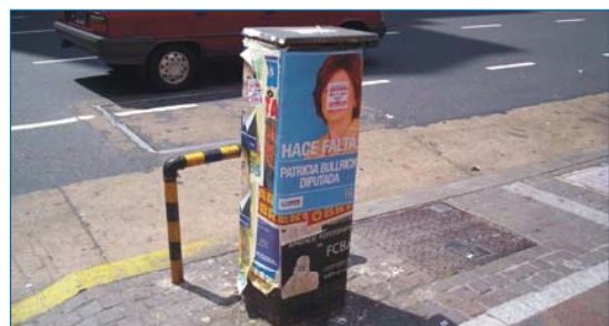
Caja conmutadora para control de semáforos
