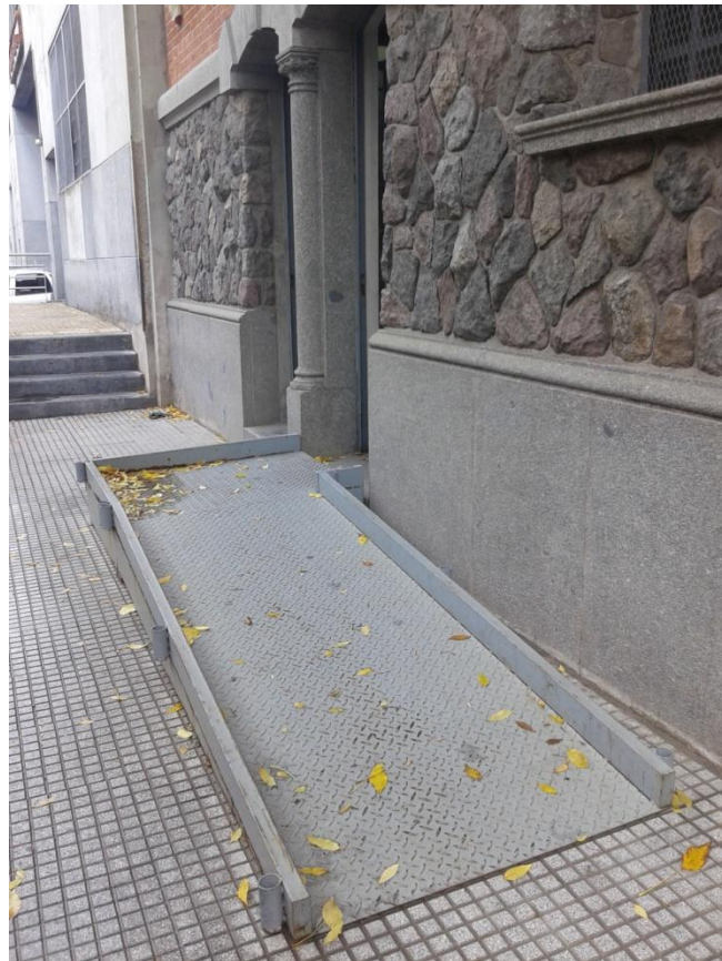
Fotografía 26: Rampa de ingreso accesible. Fuente: De Autor.
